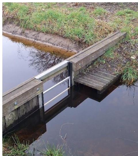
Het stuwte, zonder tussenschot. Duidelijk is aan het kale gedeelte van de oever (bovenaan op de foto) te zien hoe hoog het waterpeil was vóór het wegnemen van het tussenschot.
